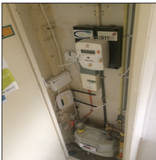
meetapparatuur in de meterkast
